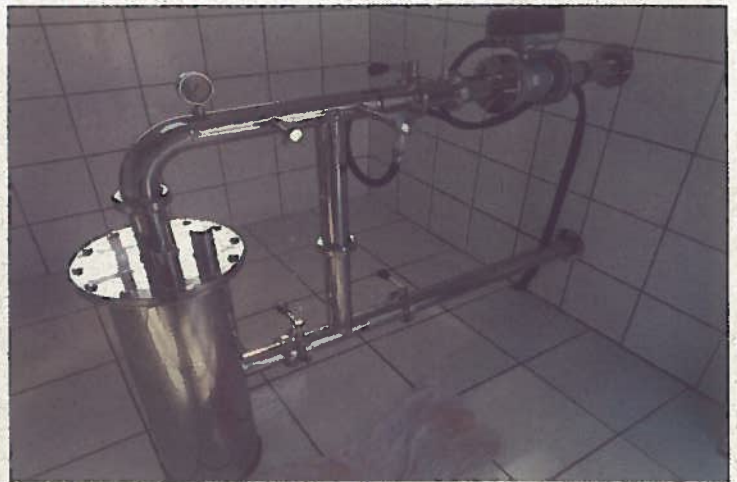
Captação da Fonte
